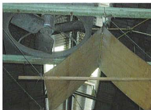
通気をよくするために天井に設けられた大型の扇風機。下に取り付けられた金属の板によって、空気が畜舎全体にいきわたるような工夫がみられる。
